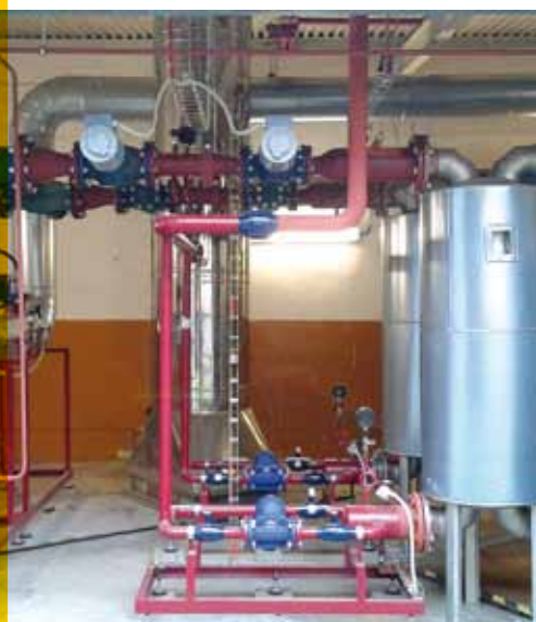
Nový centrální výměník je umístěn přímo v kotelně Olomoucká a sídliště zásobuje vodou o 90 °C.
